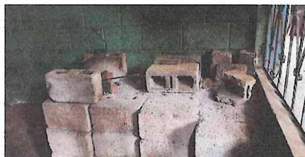
Foto 3: Cocina en mal estado.
