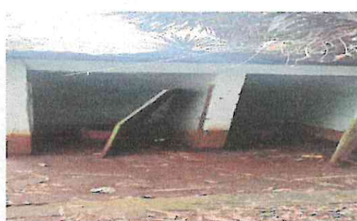
Foto 4: losa de sanitario y sanitarios en mal estado.
