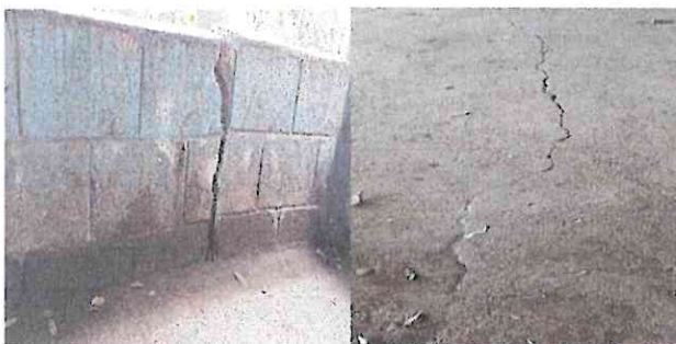
Foto 5: Piso en mal estado.
