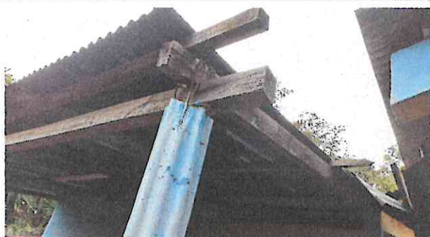
Foto 1: Costaneras en mal estado.
